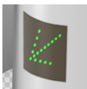
闸机待机 该方向正在通行状态
